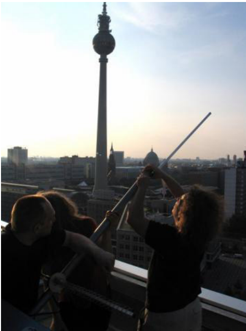
Fig. 1. Antenna installation at Haus des Lehrers, 2003. Image courtesy Freifunk.
